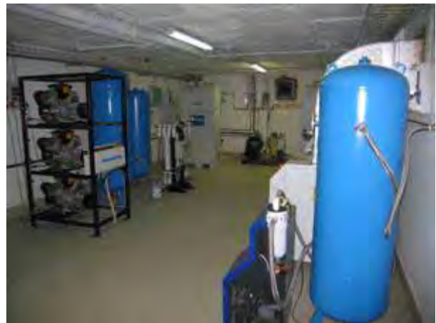
L'impianto per la produzione di ossigeno, vuoto e aria compressa
