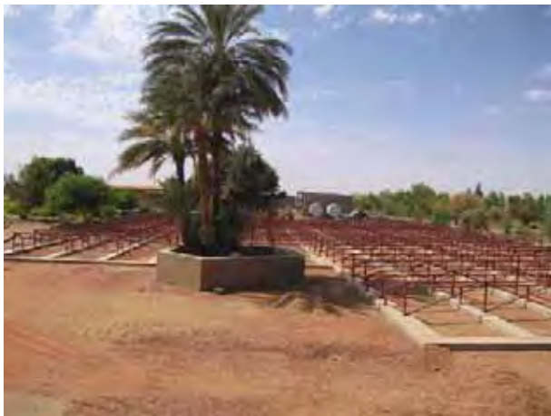
Telai per i pannelli solari: vista da retro
