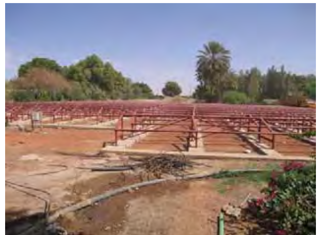
Telai per i pannelli solari: vista frontale
