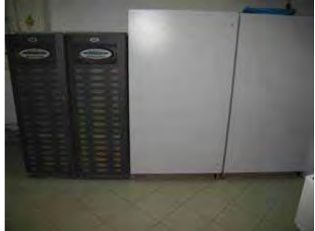
Batterie di riserva (OPS)
