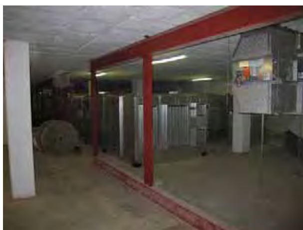
Condotti dell'aria nel seminterrato
