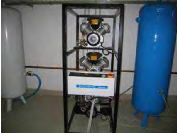
Impianto di produzione vuoto e aria compressa: dettaglio
