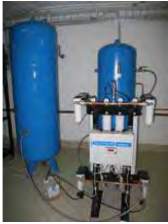
Impianto di produzione vuoto e aria compressa: dettaglio
