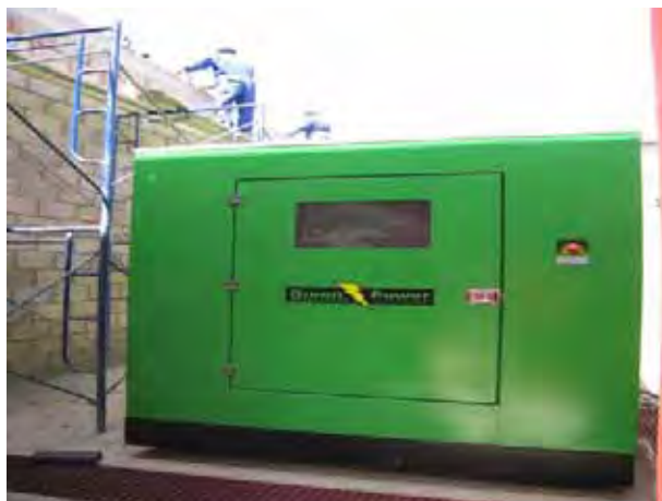
Uno dei due generatori di back-up
